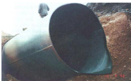
Рис. 1. Вид участка газопровода после аварии [1]
